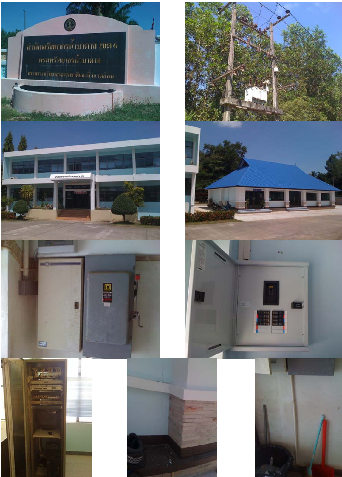
รูปที่ ง.2.6 รูปถ่ายการเข้าสำรวจระบบไฟฟ้าและป้องกันที่สำนักเขตฯ 6 ตรัง
