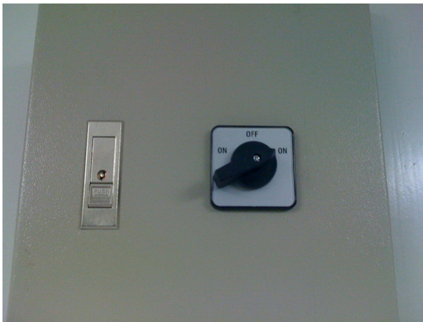
รูปที่ ง.1.3 เมนสวิตช์ใน Server room
