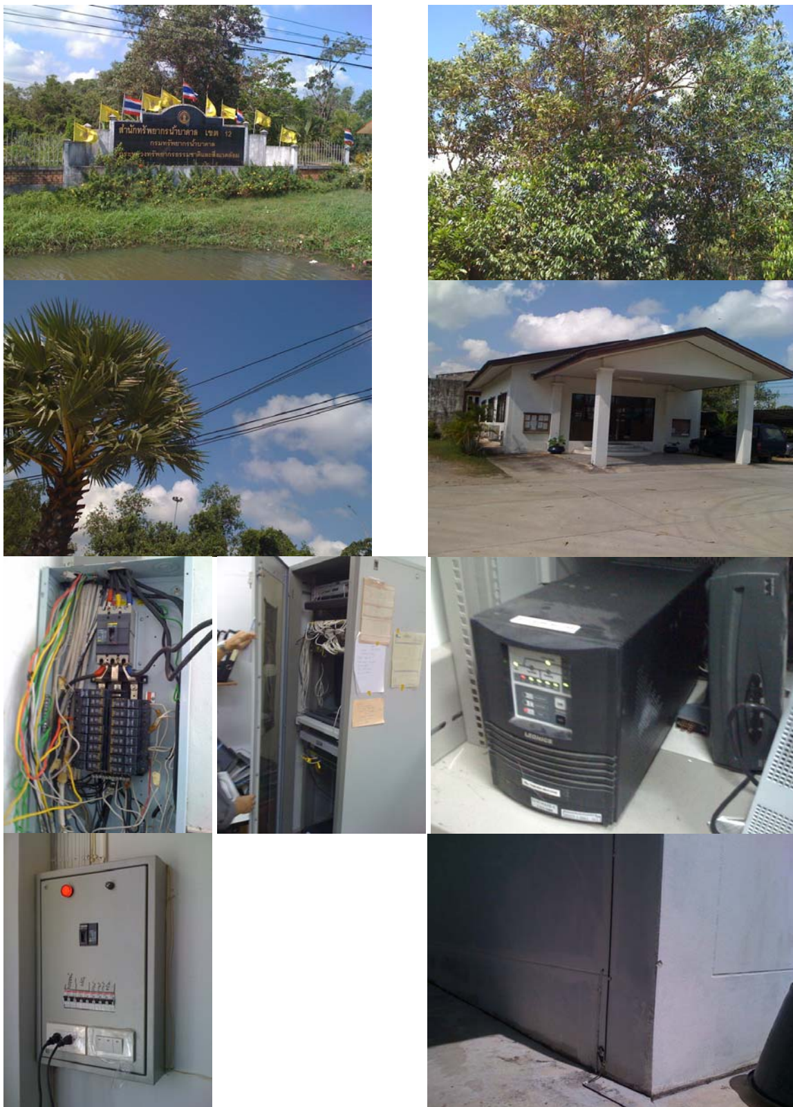
รูปที่ ง.2.12 รูปถ่ายการเข้าสำรวจระบบไฟฟ้าและป้องกันที่สำนักเขตฯ 12 สงขลา
