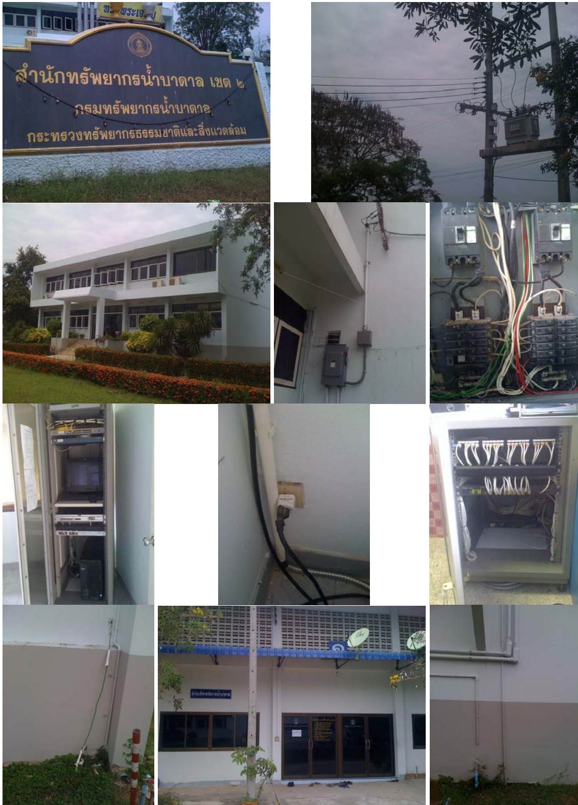
รูปที่ ง.2.2 รูปถ่ายการเข้าสำรวจระบบไฟฟ้าและป้องกันที่สำนักเขตฯ 2 สุพรรณบุรี
