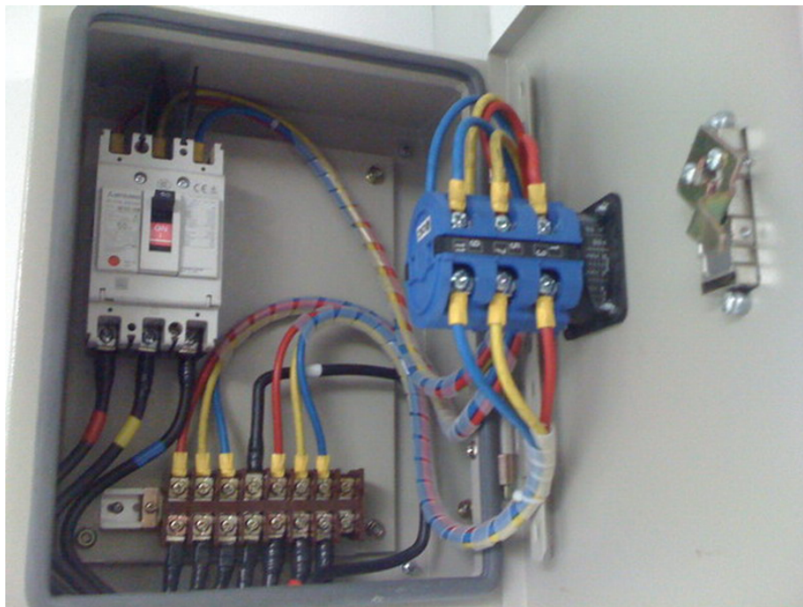
รูปที่ ง.1.4 เมนเซอร์กิตเบรกเกอร์ขนาด 50A ที่ต่อจากเมนสวิทช์ใน Server room
