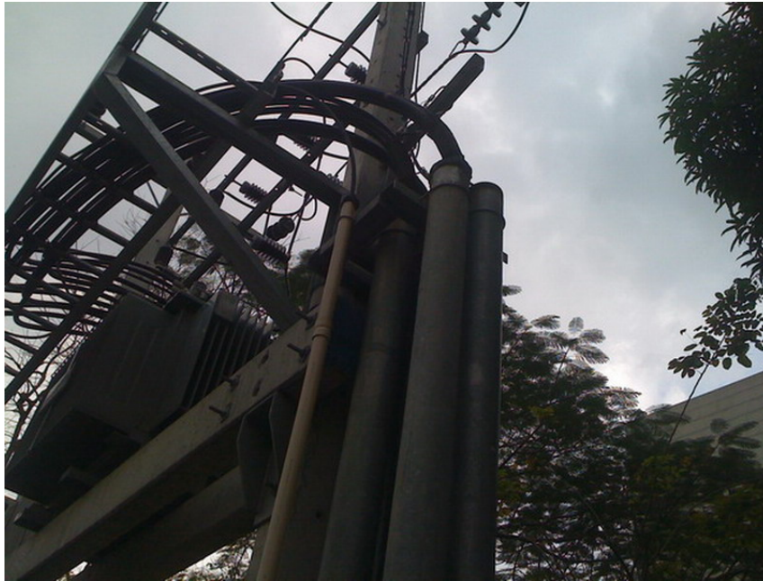
รูปที่ ง.1.2 หม้อแปลงขนาด 800kVA ที่จ่ายไฟฟ้าให้อาคาร 1
