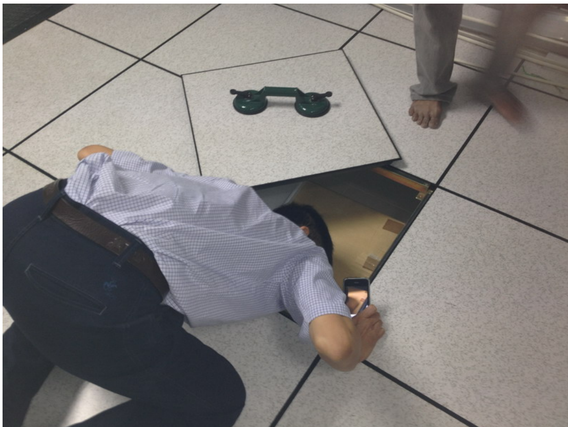
รูปที่ ข.2.1.6 รูปพื้นชนิดยกหรือ Raise Floor ในห้องเซิร์ฟเวอร์แต่ไม่มีระบบลมเป่าใต้พื้น
