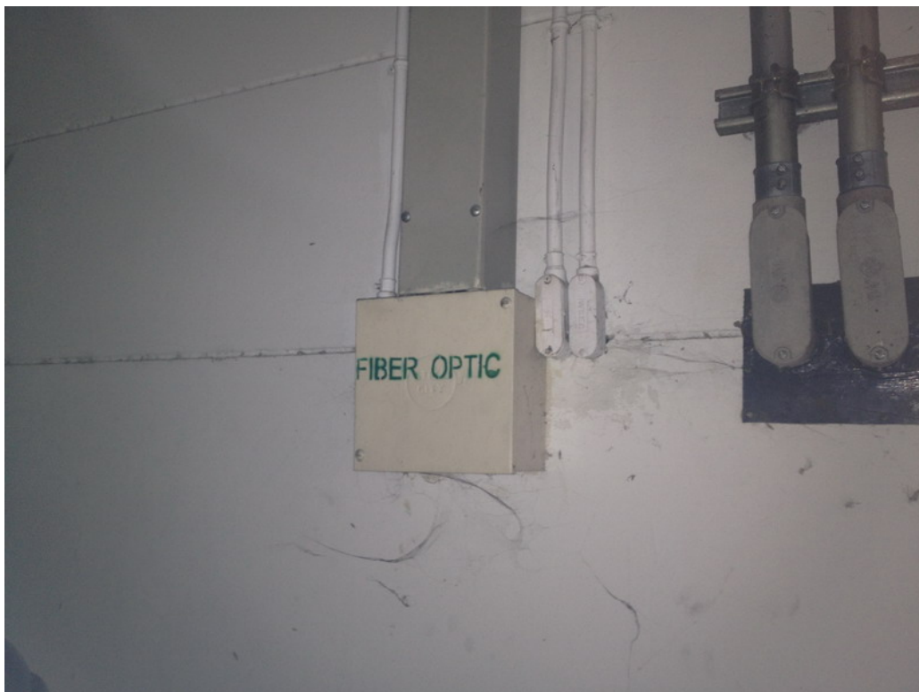
รูปที่ ข.2.1.5 กล่องเชื่อมต่อสายไฟเบอร์ออปติคบริเวณลานจอดรถชั้น 1 ใต้อาคาร 1
