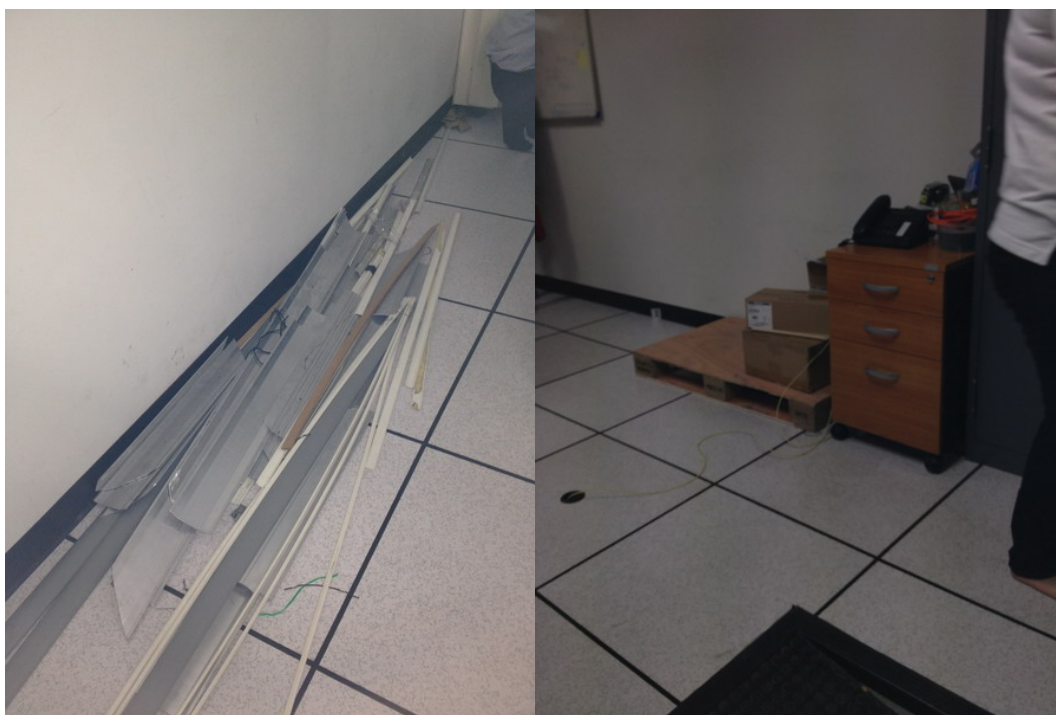
รูปที่ ข.2.1.1 สภาพห้องเซิร์ฟเวอร์บริเวณด้านหน้าทางเข้าซึ่งมีสิ่งกีดขวาง
