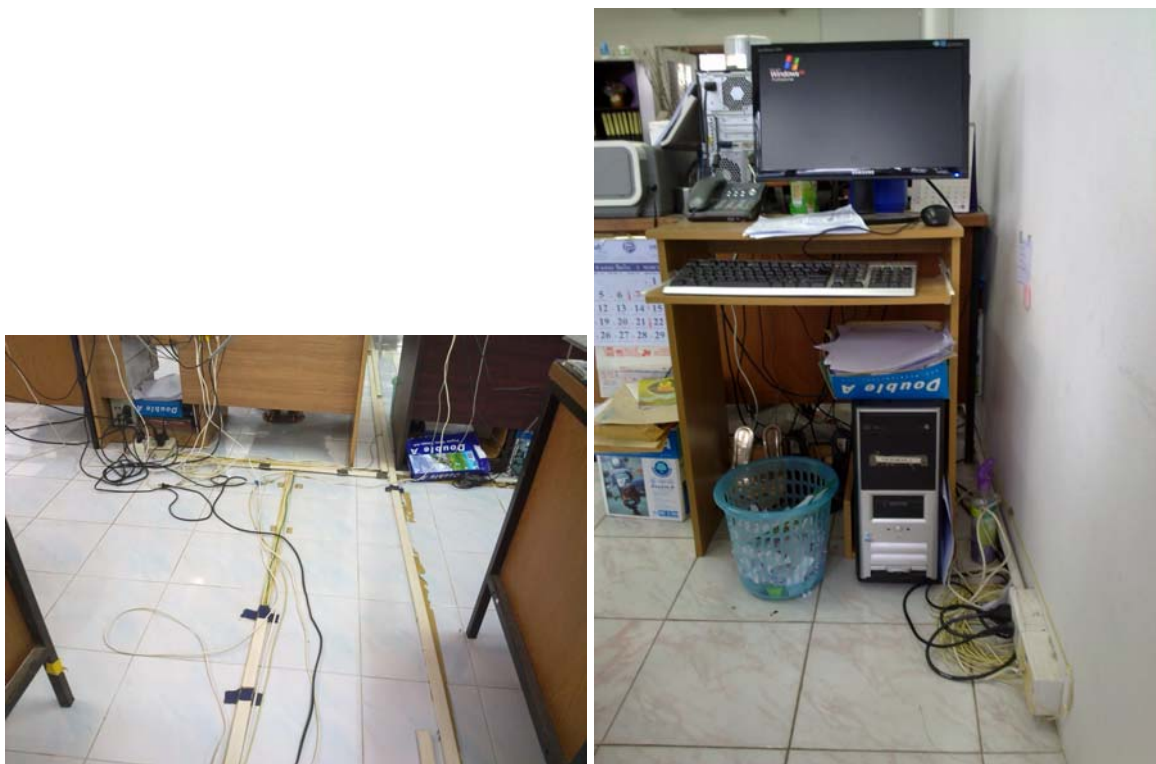
รูปที่ ข.2.2.1 สภาพการเดินสายไฟและสายสัญญาณ (ซ้าย) และสภาพโต๊ะทำงานซึ่งเล็กต้องจัดวางคอมพิวเตอร์บนพื้น (ขวา)
