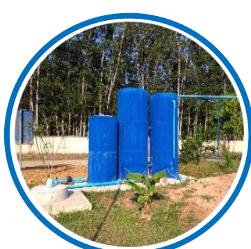
ถังเก็บน้ำและถังกรองน้ำ
