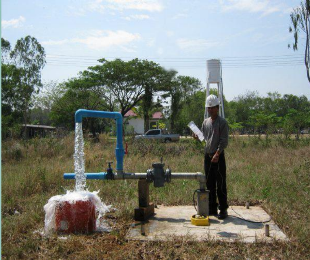
บ่อน้ำบาดาล
