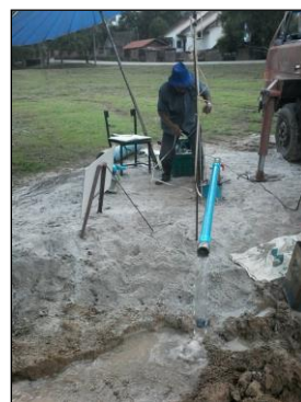
ภาพถ่ายบ่อน้ำบาดาล
