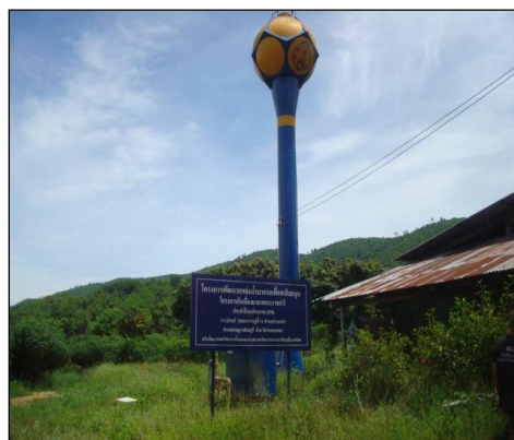
ภาพถ่ายระบบประปาบาดาล
