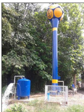
ภาพถ่ายระบบประปาบาดาล
