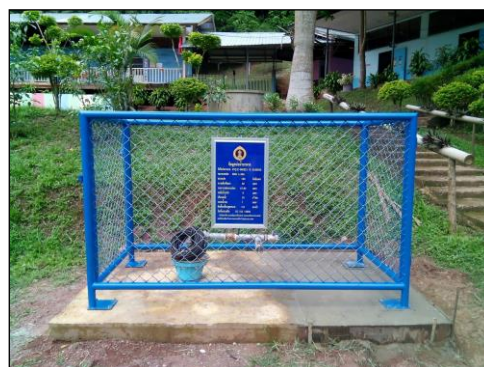
ภาพถ่ายบ่อน้ำบาดาล
