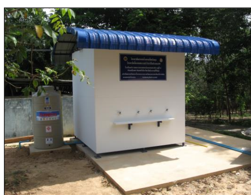
ภาพถ่ายระบบปรับปรุงคุณภาพน้ำ (บ้านน้ำดื่ม)
