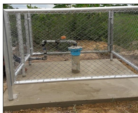
ภาพถ่ายบ่อน้ำบาดาล
