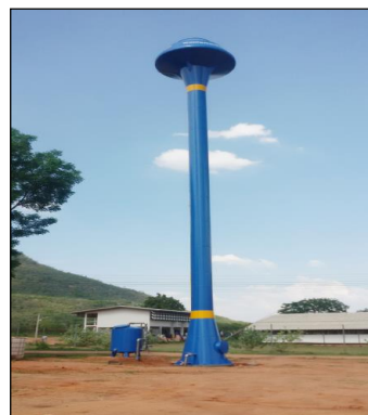
ภาพถ่ายระบบประปาบาดาล
