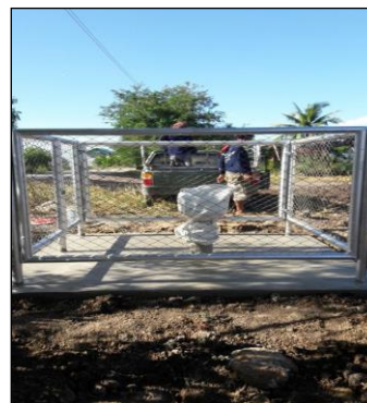
ภาพถ่ายบ่อน้ำบาดาล
