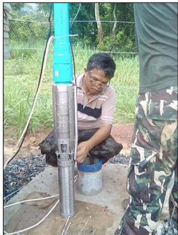
ภาพถ่ายการติดตั้งเครื่องสูบน้ำประจำบ่อน้ำบาดาล
