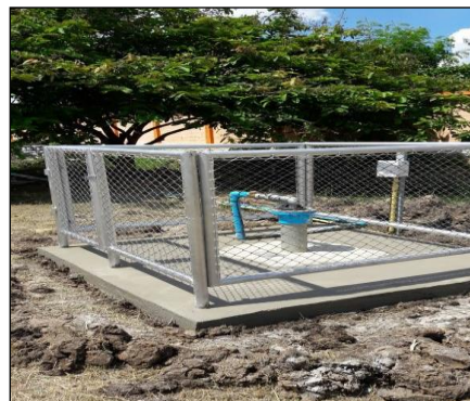
ภาพถ่ายบ่อน้ำบาดาล
