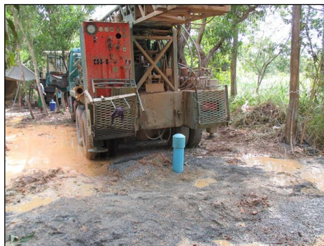
ภาพถ่ายบ่อน้ำบาดาล
