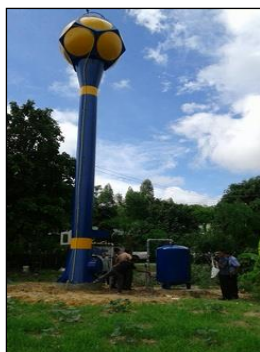
ภาพถ่ายหอดักเก็บน้ำระบบประปาบาดาล ขนาด 12 ลบ.ม.
