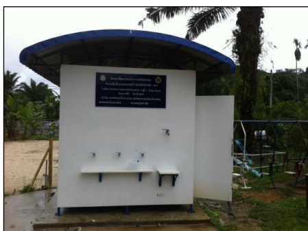
ภาพถ่ายระบบปรับปรุงคุณภาพน้ำ (บ้านน้ำดื่ม)
