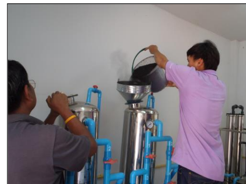
ภาพถ่ายเปลี่ยนสารกรองระบบปรับปรุง
