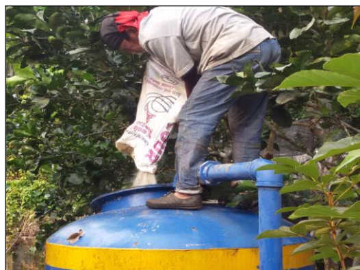
ภาพถ่ายเปลี่ยนสารกรองถังกรองสนิมเหล็ก
