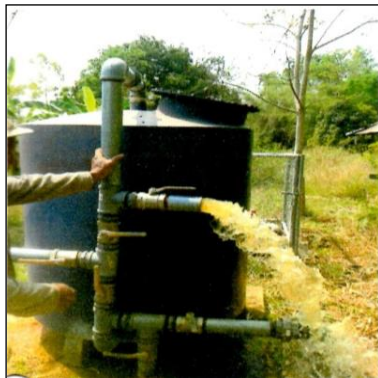
ภาพถ่ายการล้างย้อนกลับถังกรองสนิมเหล็ก
