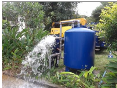
ภาพถ่ายการล้างย้อนถังกรองสลิมเหล็ก
