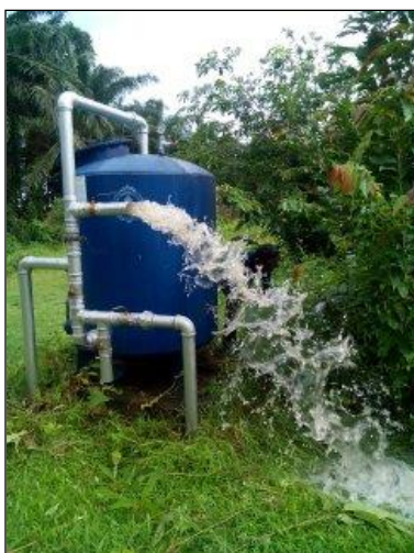
ภาพถ่ายการล้างย้อนกลับถังกรองสนิมเหล็ก
