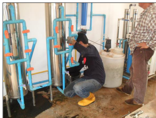
ภาพถ่ายเปลี่ยนสารกรองระบบปรับปรุงคุณภาพน้ำ
