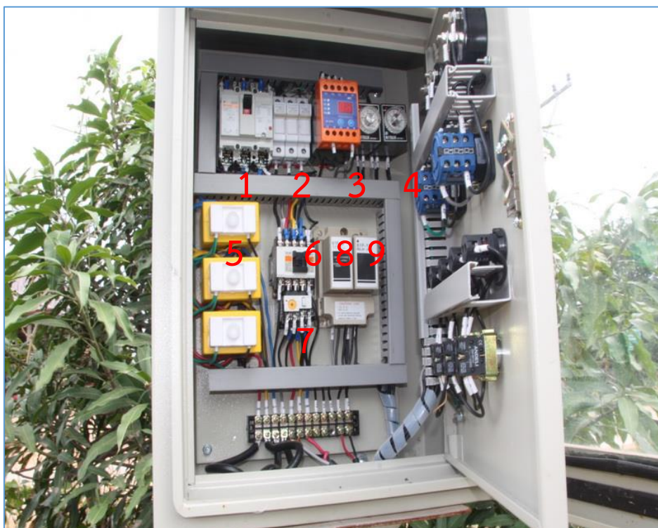
อุปกรณ์ภายในตู้ควบคุม
