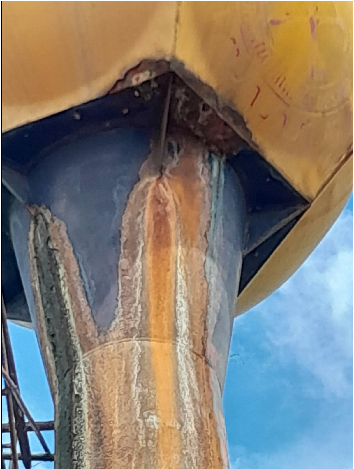
รูปภาพหอดังสูงเหล็กประปาหมู่บ้านรูปทรงแซมแปญ บ.ปงสนุก ม.8 ต.ห้วยยางขาม อ.จุน จ.พะเยา
